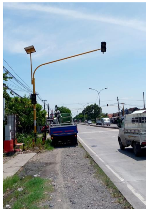
Pemeliharaan Warning Light Solar Cell
